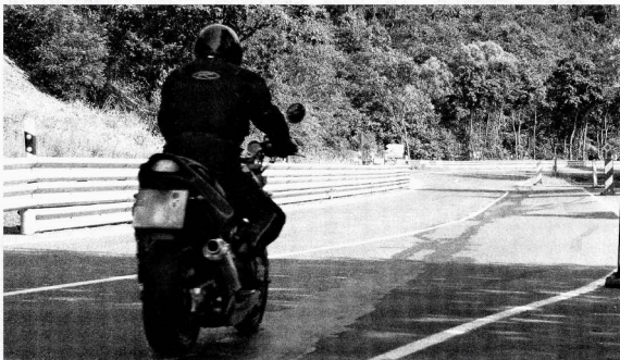
Bitumenflicken können zum Sturz führen. Diese gefährliche Flickstelle wurde direkt nach der Meldung repariert. (Foto: Tourenfahrer)
